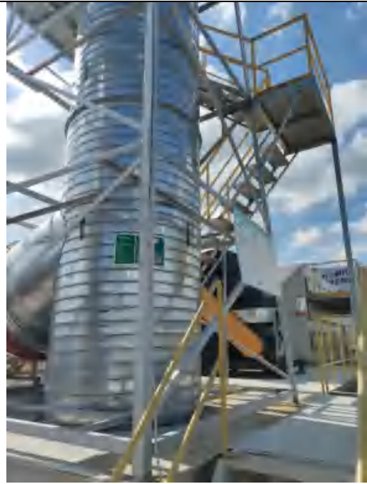
图 4.2-16 新增三车间硫化废气 DA061 排放口远照（排污证编号）
